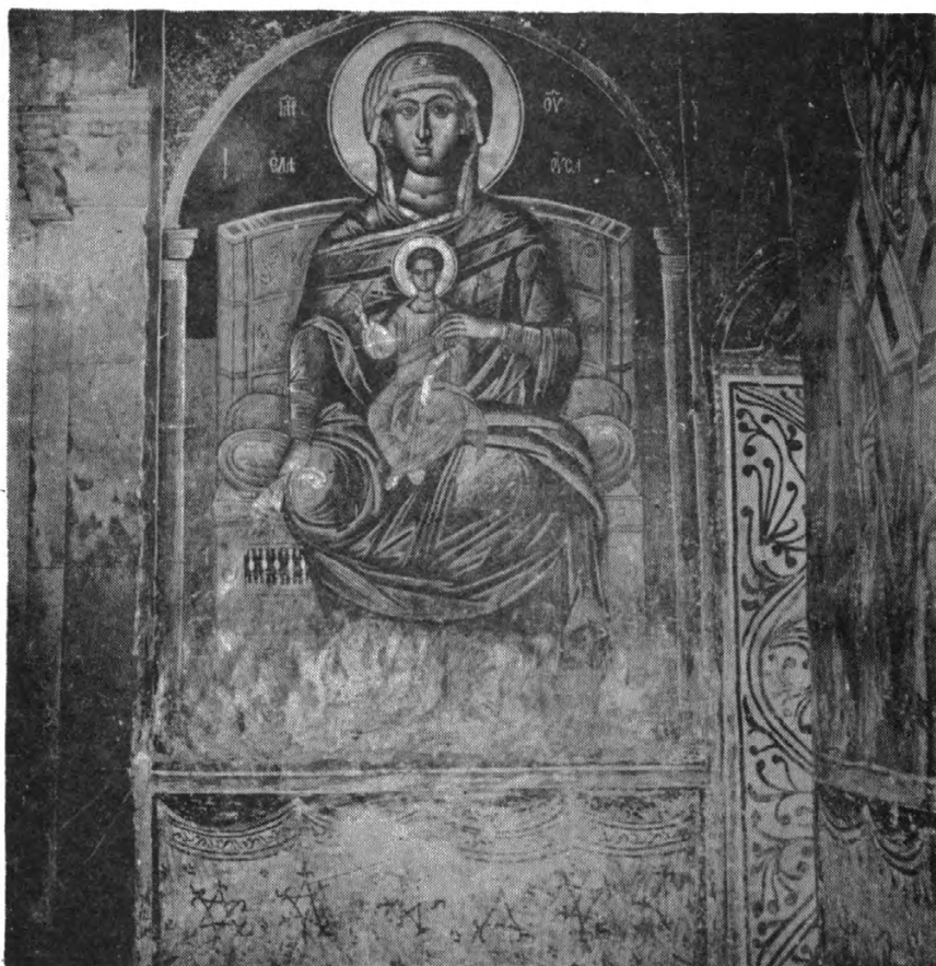
sl. 1. Izgled istočnog zida sjeverne Pijevnice sa oštećenjima izazvanim prodromom vlage
