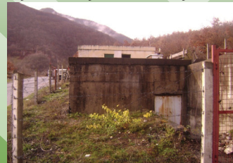
Prekidna komora na vodovodu Berane
