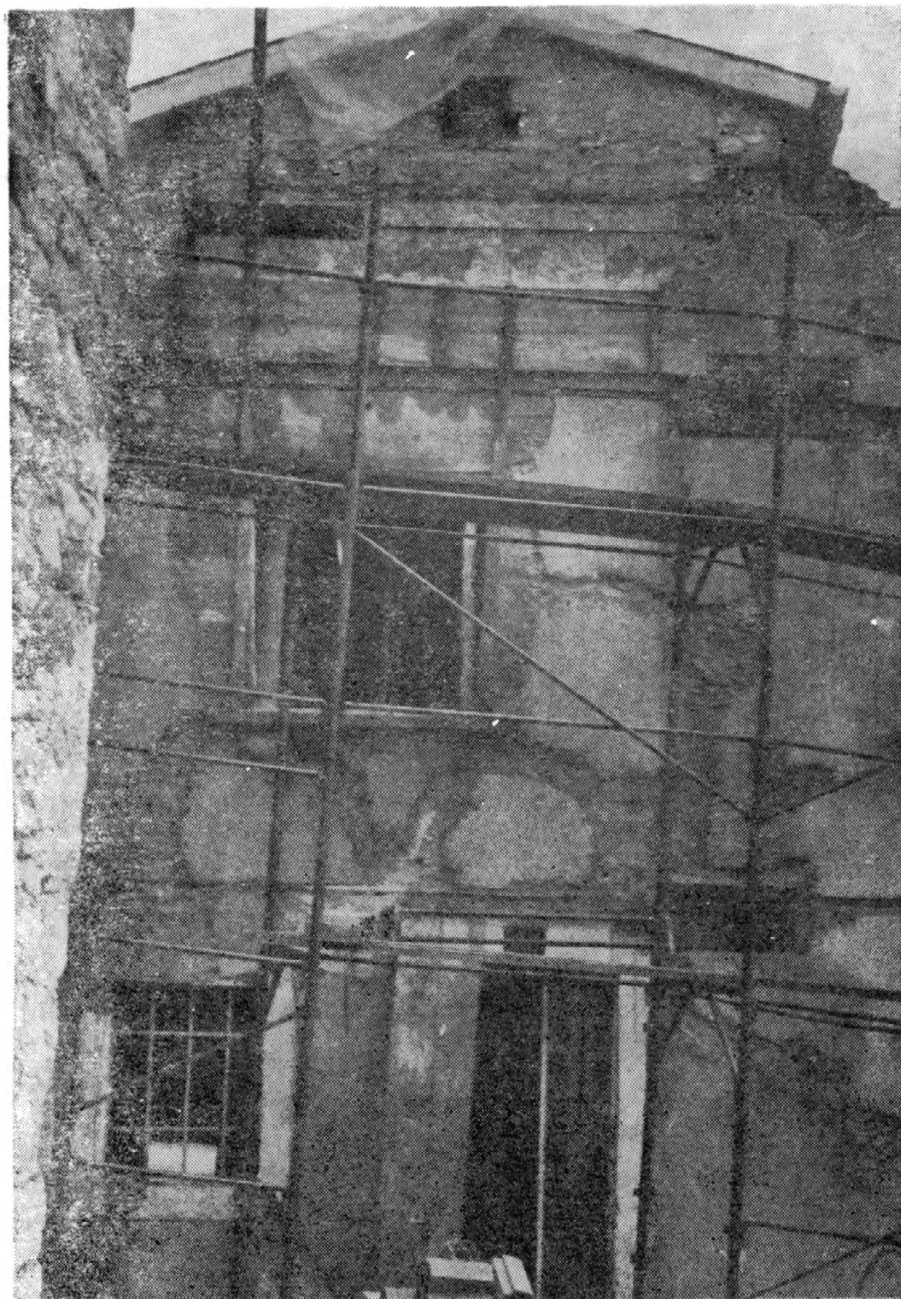
Sl. 8: Sanirana i ojačana kamena zgrada u Luseveri, Italija, posle zemljotresa u septembru 1976. godine
