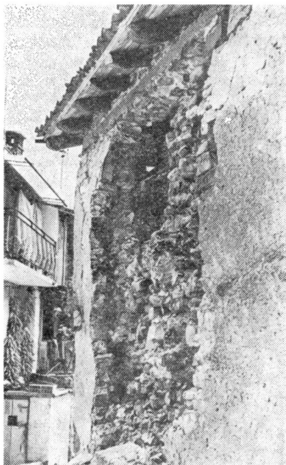
Sl. 4: Delimično rušenje zida u pravcu seizmičkog dejstva
