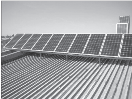
Slika 1. Izgled solarne elektrane snage 2 kW na krovu PMF-a u Nišu
