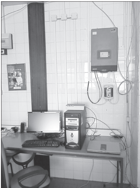
Slika 2. Deo unutrašnjosti Laboratorije za solarnu energetiku na PMF-u u Nišu sa postavljenim invertorom i pratećom opremom za monitoring i akviziciju podataka solarne elektrane od 2 kW
