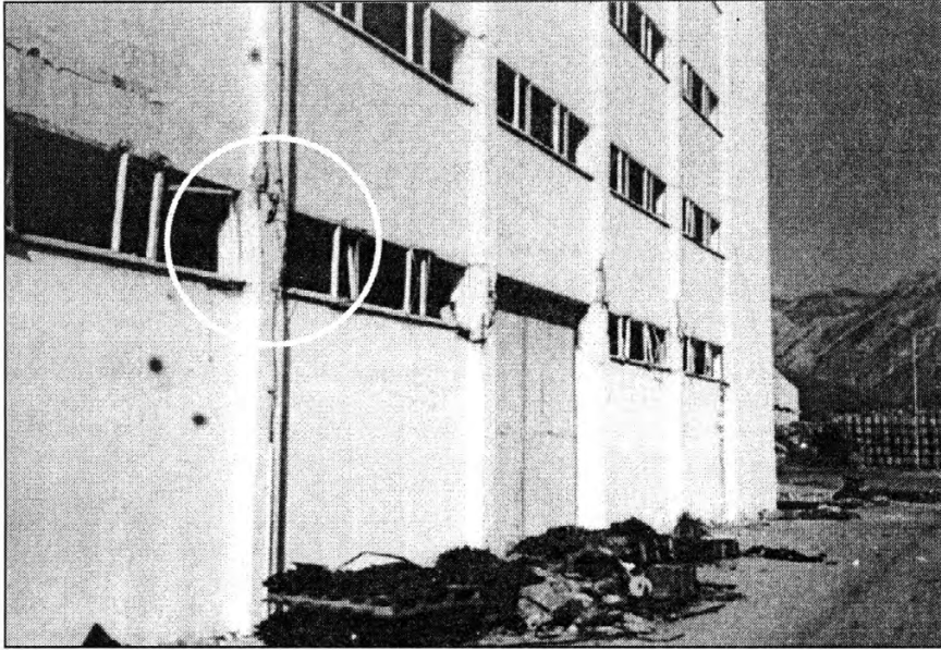
Slika 7. Skladište u luci Bar u skeletnom sistemu sa dijafragmama: krti lom stubova zbog krutih zidova ispune.
