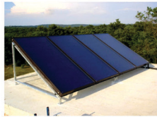
Pločasti kolektori na betonskoj ploči, Kanfanar-Rovinj
